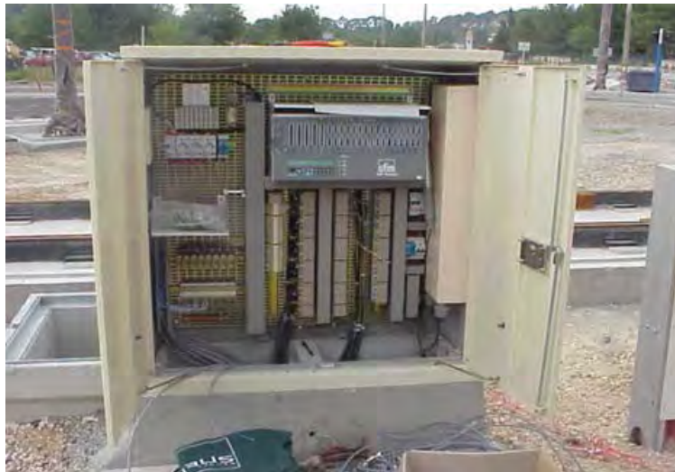
Figure 17 : Photo d'un coffret sur site
