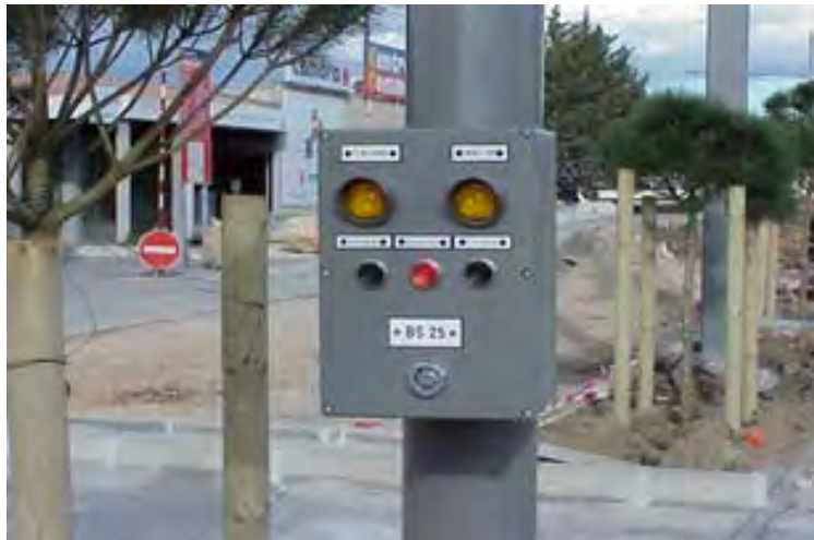
Figure 16 : Photo d'un boîtier de commande d'itinéraire à pied d'oeuvre
